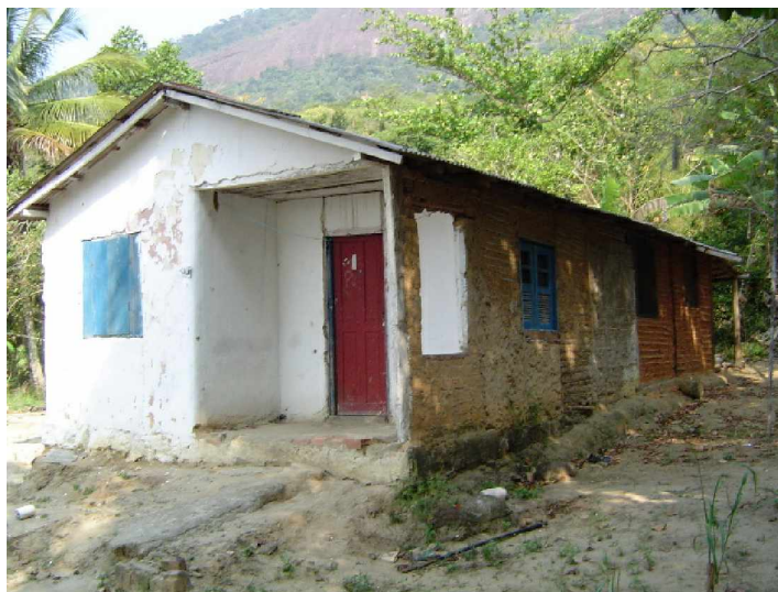
Figura 16 – Ampliação da casa de estuque na Ilha da Marambaia, pelos moradores em 2004, após intervenção do Ministério Público.
