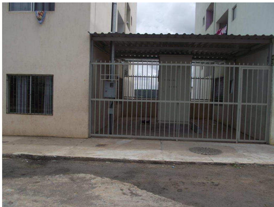
Figura 8 – Utilização de vão entre os conjuntos habitacionais para instalação de central de equipamentos de telefonia. Viçosa, MG.
