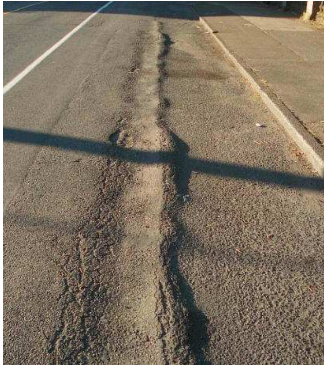
Figura 2.6: Exemplo de afundamento de trilha-de-roda de pavimento asfáltico em ponto de ônibus de vias urbanas.
