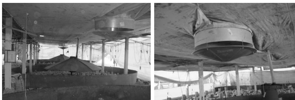
FIGURA 1. Sistema de ventilação mínima por pressão positiva (ventilador). Ventilador posicionado no interior da instalação ao nível do forro, com defletor acoplado, visando evitar a incidência do jato de ar diretamente sobre as aves.
