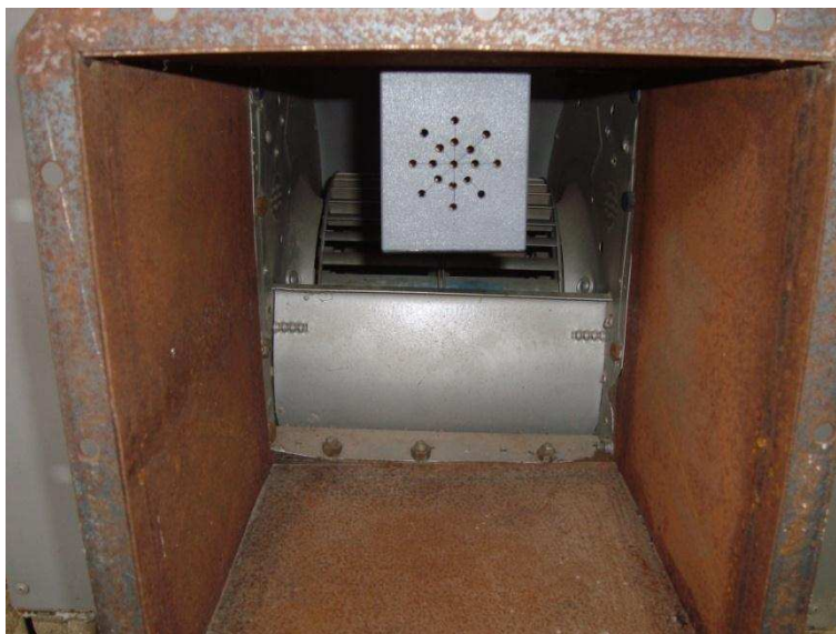
Figura 40 - Sensores de temperatura e umidade relativa instalados na saída da bomba de calor
