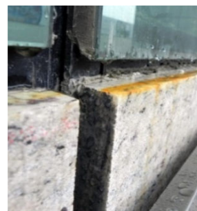
Figura 4 – Mancha na pedra (corrosão metálica)
