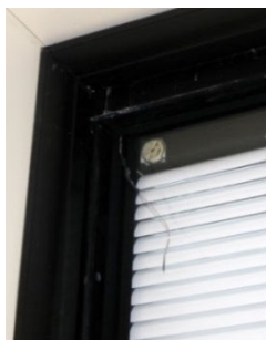
Figura 17 – vidro fissurado internamente
