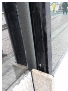
Figura 18 – Falta peça para plano transversal
