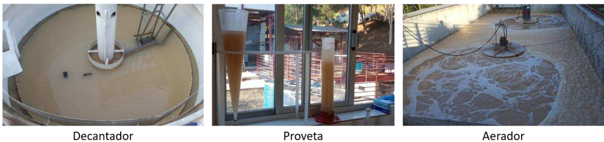
Figura 4 – Pontos de coleta Aerador (Ponto 6), Proveta e Decantador (Ponto 7), da estação de tratamento de efluentes da indústria
