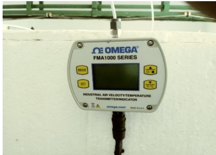
Figura 16 – Display do sensor de velocidade e da temperatura ÔMEGA FM 1000 preso ao túnel.
