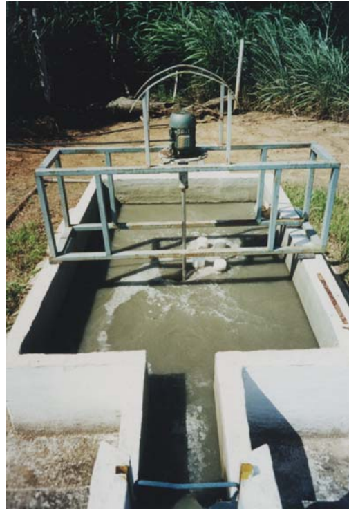
Figura 2A. Tanque de equalização.
