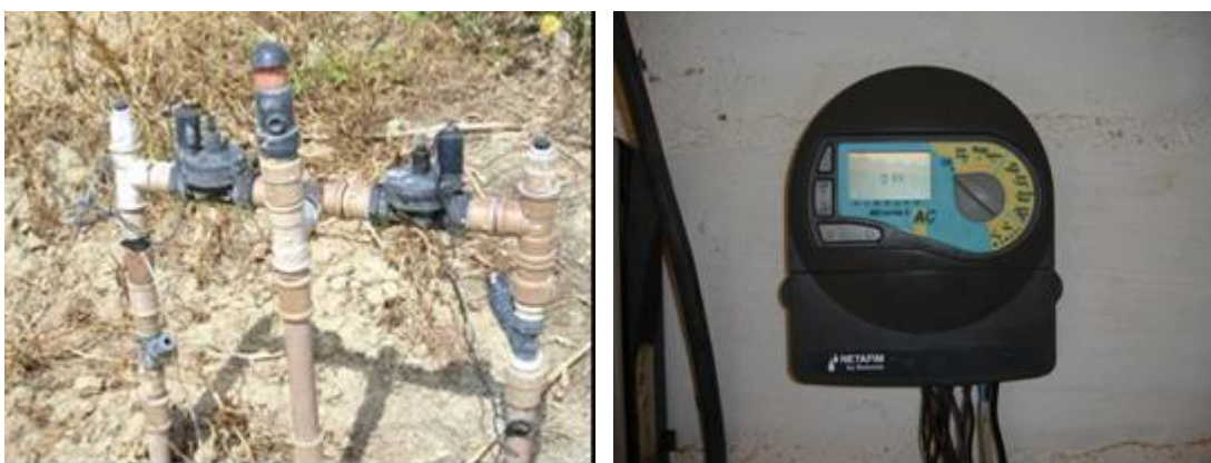
Figura 3 – Válvulas solenóides com os reguladores de pressão (A) dispostas no campo e o controlador computadorizado (B).
