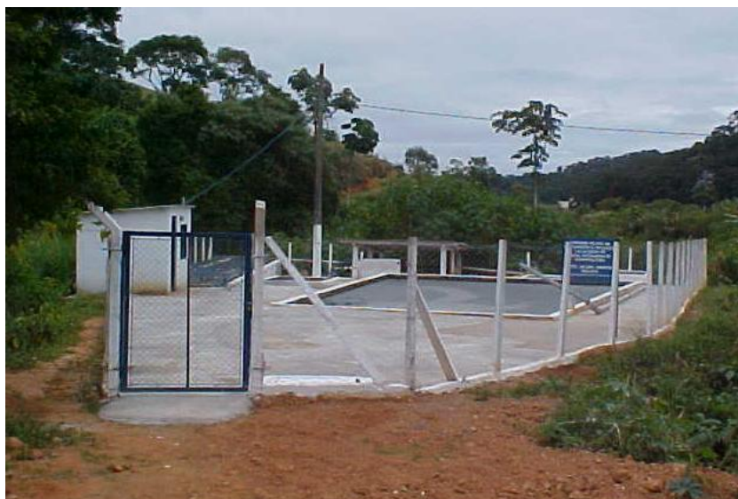
Figura 2 - Vista da Unidade de Tratamento de Água Residuária de Suinocultura (UTARS).
