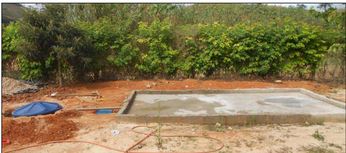
Figura 3-9. Execução da camada de concreto com agregados reciclados de RCC e instalação das caixas coletoras de água.
