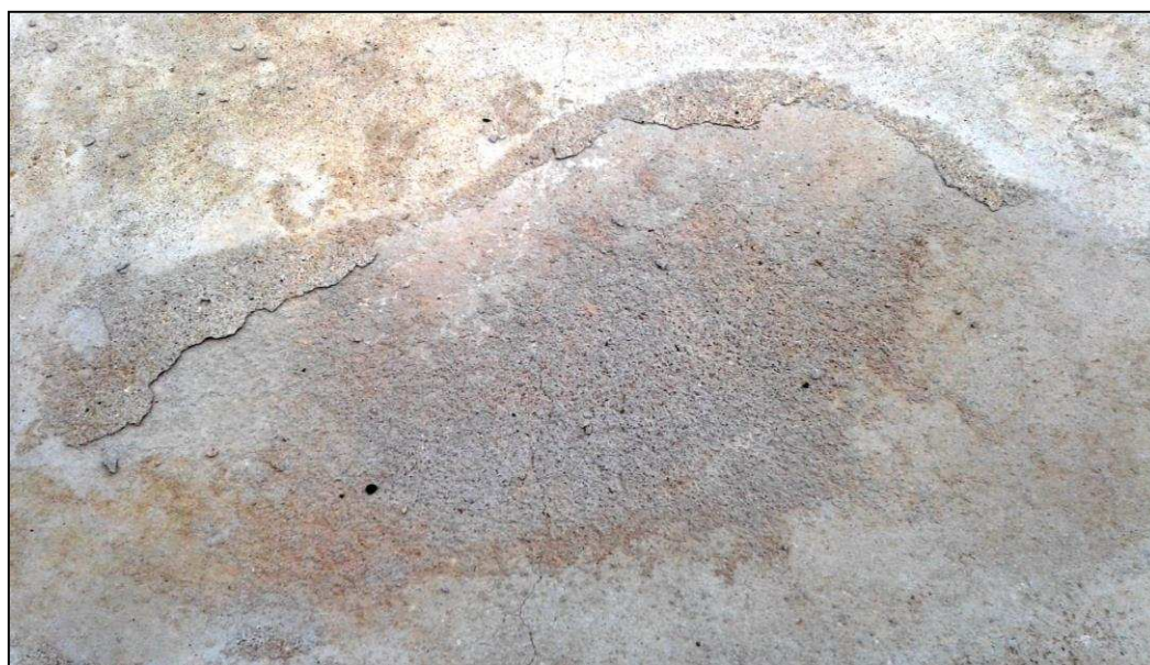
Figura 4-36. Fissuras do pátio executado com agregados de RCC.
