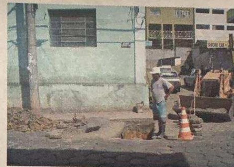
A empresa vencedora da licitação até o momento só executou este buraco defronte a Camiv, no Bairro de Lourdes
