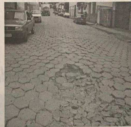
Por falta de rede de escoamento pluvial, as águas dos morros "carregam" os bairros da parte alta, arrancando os calçamentos da parte baixa
