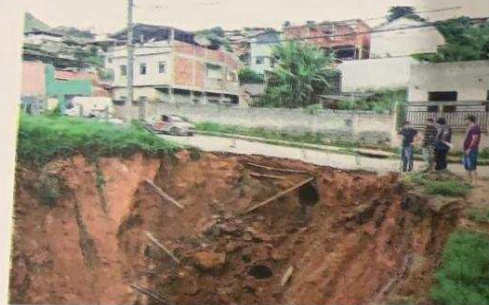
A Prefeitura está prometendo concluir a recuperação da rua Assad Nazar nos próximos 10 dias
