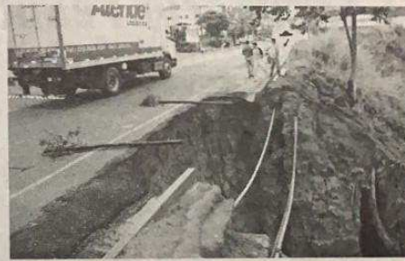
Na avenida Maria de Paula Santana a recém mal acabada obra de recuperação do acostamento realizada por empreiteiras do Departamento Nacional de Infraestrutura e Transporte (DNIT) cedeu com as primeiras águas
