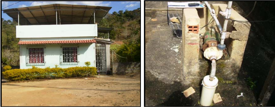
Figura 26 - Ponto de coleta 7 - Poço Tubular I.
