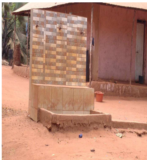
Figura 4. Imagem do furo de bomba de água em estado de degradação, Bijimita, Guiné-Bissau.
