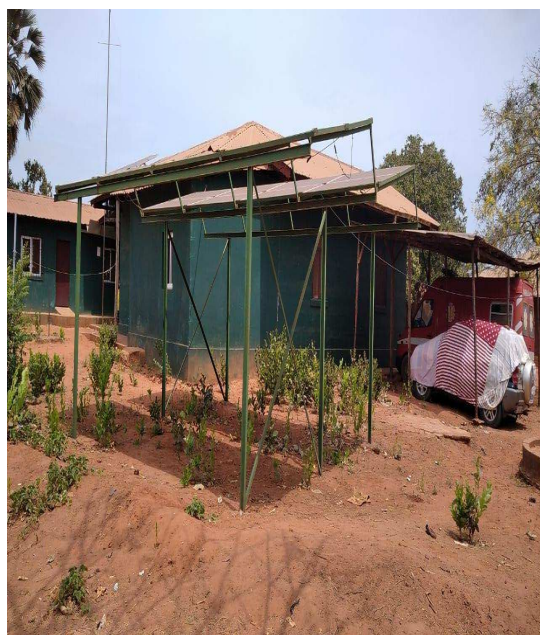
Figura 3. Imagem dos painéis solares do posto de saúde, Bijimita, Guiné-Bissau.
