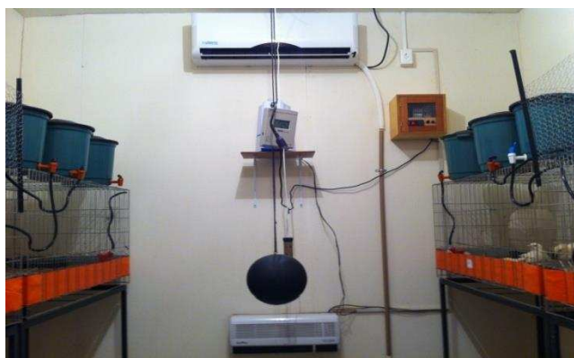
Figura 5. Detalhe do posicionamento globo negro instalado no interior da câmara climática
