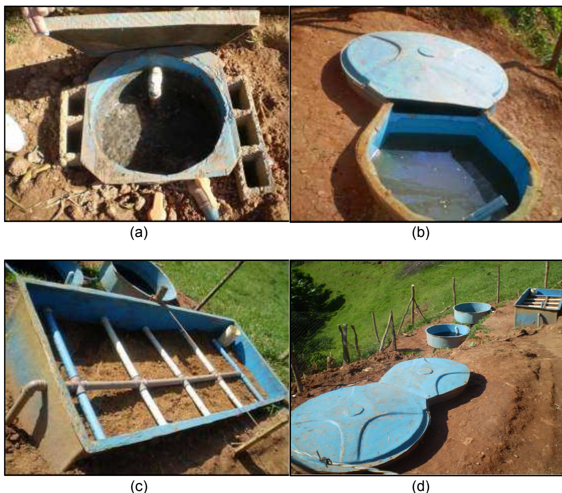
Figura 2 - Ilustração dos componentes da estação para tratamento de águas negras: (a) caixa de gordura; (b) tanque séptico; (c) filtro biológico e reatores solares; e (d) vista geral do sistema.
