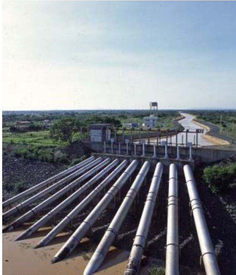
Figura 1 – Imagem da Estação de Bombeamento (EB1) do Projeto Jaíba, localizada no Rio São Francisco, com vista do Canal Principal.
