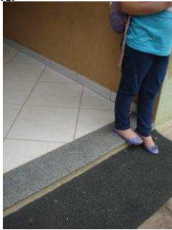
Figura 21: Desnível acima do piso
