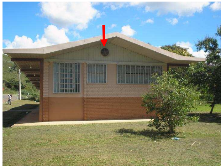
Figura 42- Exaustores nas extremidades da edificação.
