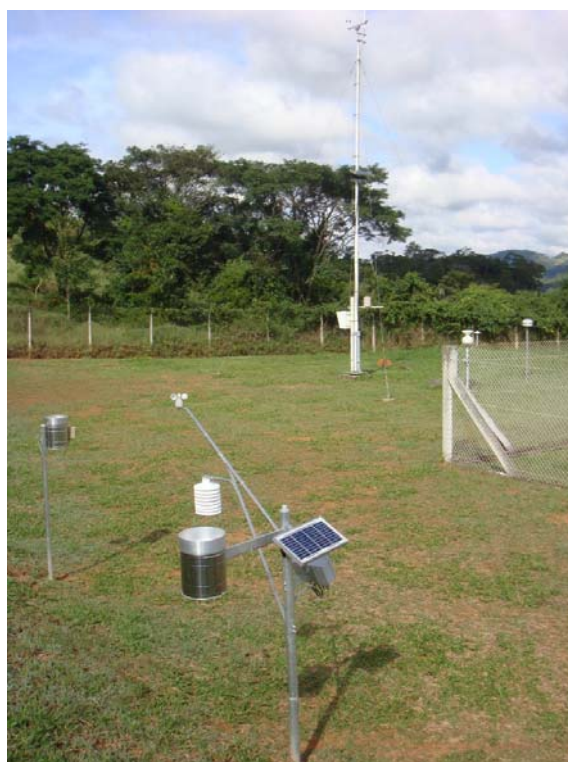
Figura 24 – Instalação da EMA desenvolvida ao lado da EMA do INMET.
