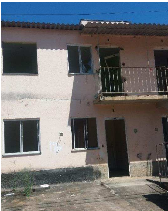
Figura 19 – Apartamento vazio e depredado, Condomínio Residencial Nova Muriaé, 2018.
