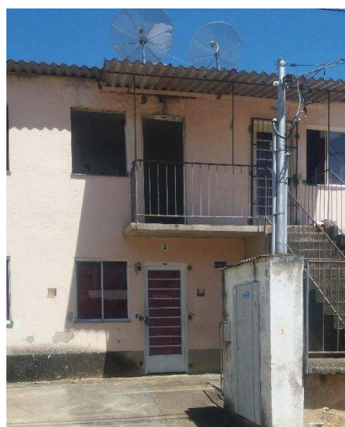
Figura 20 – Apartamento vazio e depredado, Condomínio Residencial Nova Muriaé, 2018.
