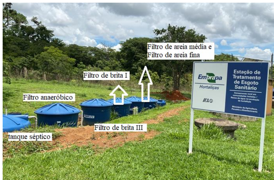
Figura 2: 1ª caixa: tanques sépticos; 2ª caixa: tanque com filtros biológicos (anaeróbico); 3ª caixa: tanque com filtro lento (pedra brita III); 4ª caixa: tanque com filtro médio (pedra brita I); 5ª e 6ª caixas: tanque com filtro médio e rápido (areia média e areia fina) e 7ª caixa: tanque de desinfecção com cloro (efluente tratado). Fonte: a autora, novembro 2021, Distrito Federal.
