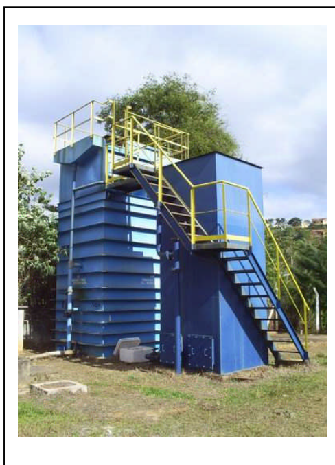
Figura 4.1 – Vista do sistema UASB + BF, ETE Violeira, Viçosa - MG
