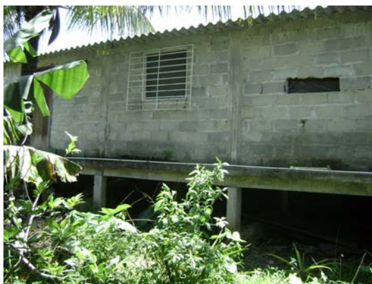
Figura 10: Sistema suspenso 1 metro do piso para evitar perda de animais na época que há enchente.
