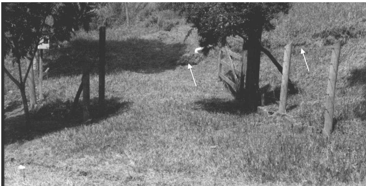
-Figura12, linha de ruptura próxima ao SPT 4B.
