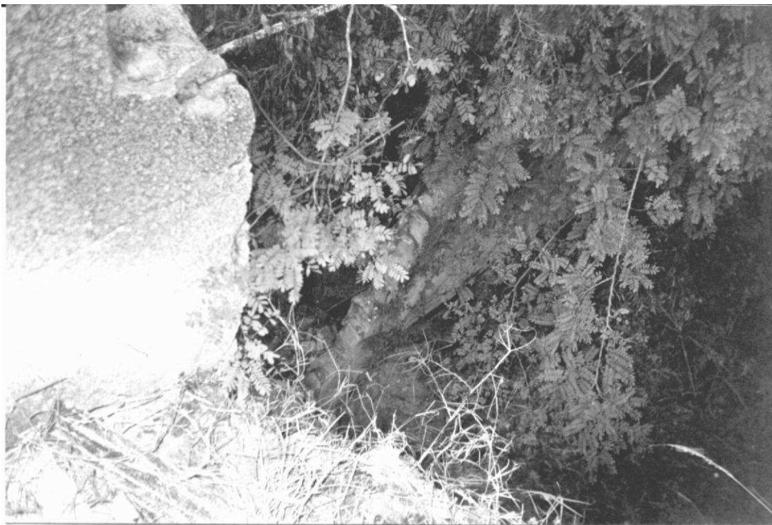
-Figura 01, muro seccionado por ruptura do solo.
