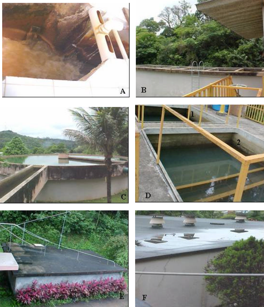
Figura 12 – Estação de Tratamento de Água da Universidade Federal de Viçosa, Minas Gerais. (A) Calha Parshal com dosador de sulfato de alumínio; (B) floculador hidráulico; (C) Decantador; (D) Filtros: 1 - filtro 1 e 2 - filtro 2; (E) Tanque de contato e (F) Reservatório.
