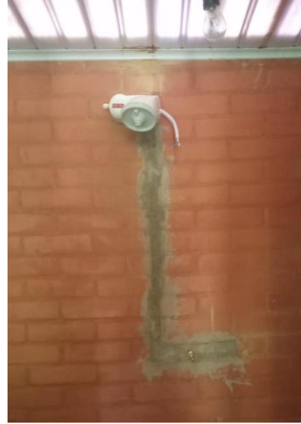
Foto 17 - Chuveiro instalado no banheiro.
