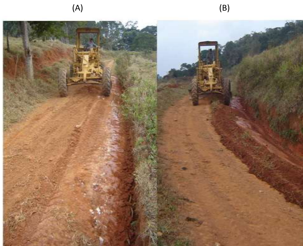
Figura 4 - Adequação do canal da estrada do trecho 1, localizado no horizonte B (A); e do trecho 2, localizado no horizonte C (B).
