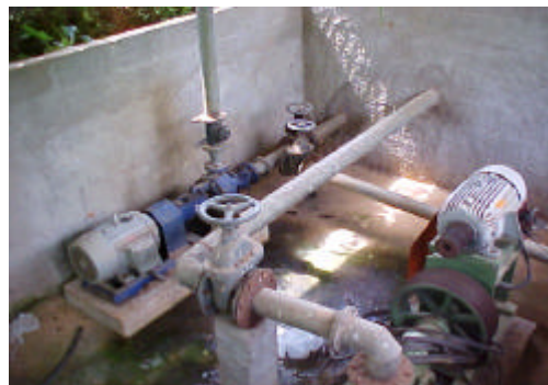
Figura 9: Detalhe do equipamento utilizado para bombear ARS para o reservatório de estocagem
