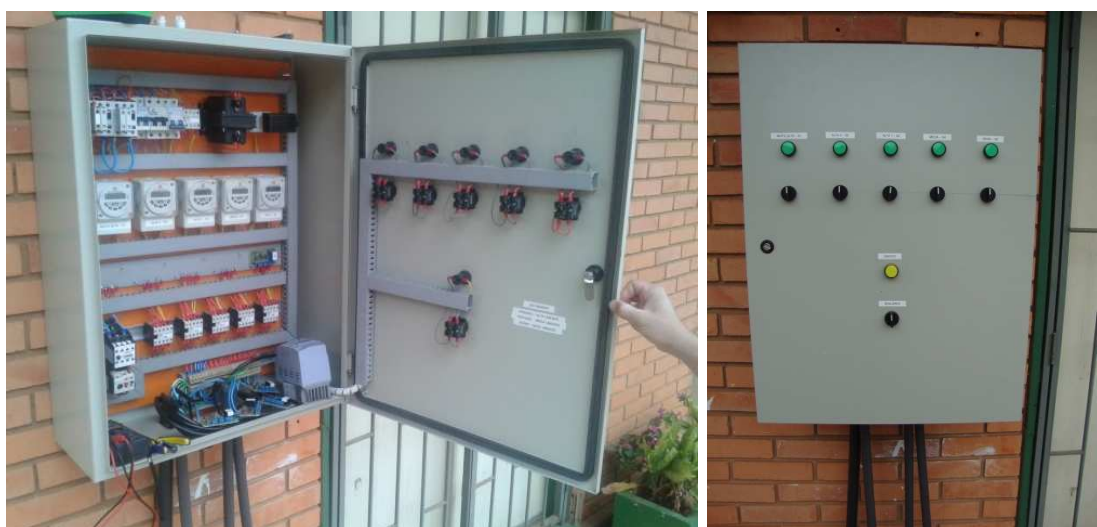
Figura 6 – Painel de controle do sistema de irrigação
