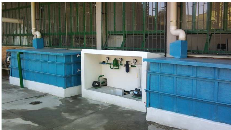
Figura 1 – Unidade de aproveitamento de água pluvial
