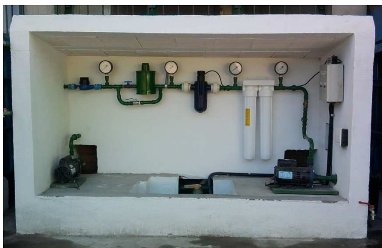
Figura 2 – Sistema de tratamento de água pluvial
