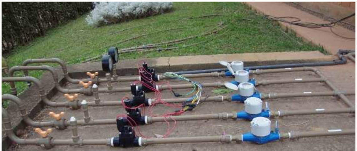
Figura 5 – Válvulas solenoides do sistema de irrigação
