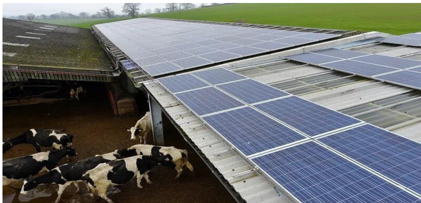
Figura 7 - Placas fotovoltaicas sobre um telhado de uma instalação rural
