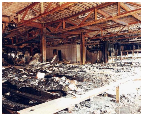
(b) Interior da edificação após o incêndio.
