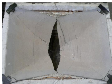
(d) Modo de colapso em situação de incêndio.
