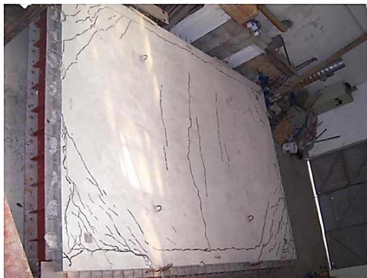
(b) Padrão de fissuras no modelo experimental. Fonte: Li, Zhang e Jiang (2017).
