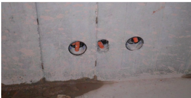
Figura 12: Instalação elétrica embutida. Fonte: autora.
