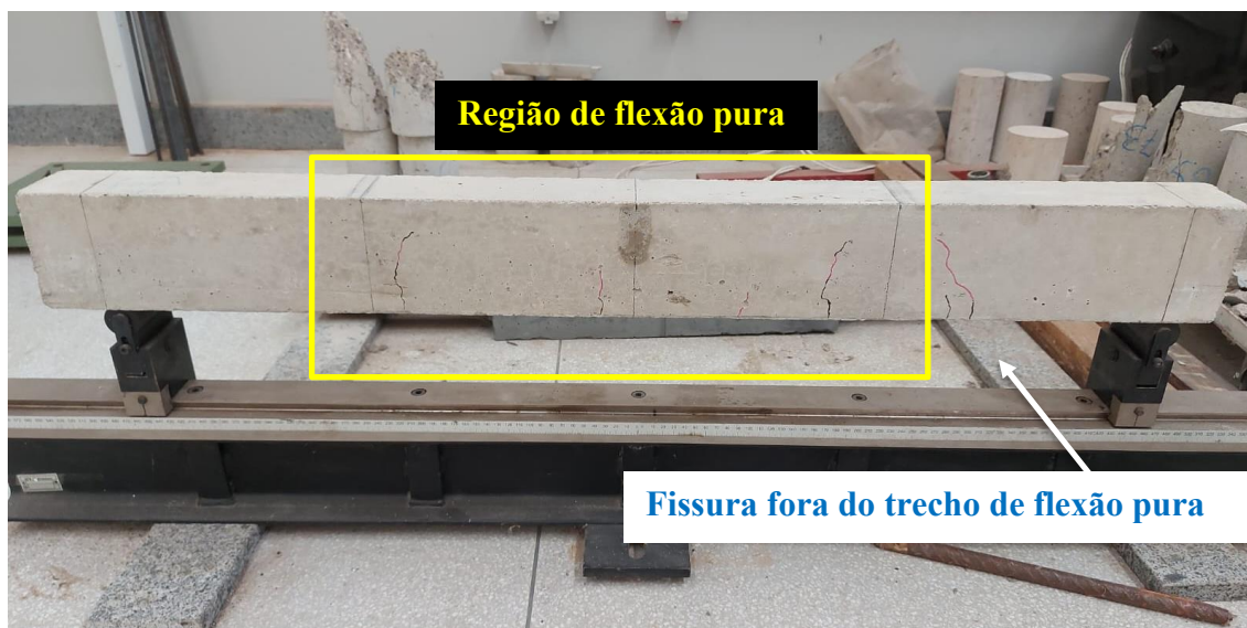
Figura 4.20: Fissuras viga V9 após ELS
