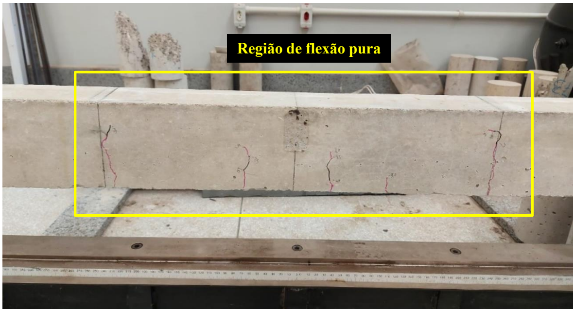
Figura 4.18: Fissuração viga V8 após ELS
