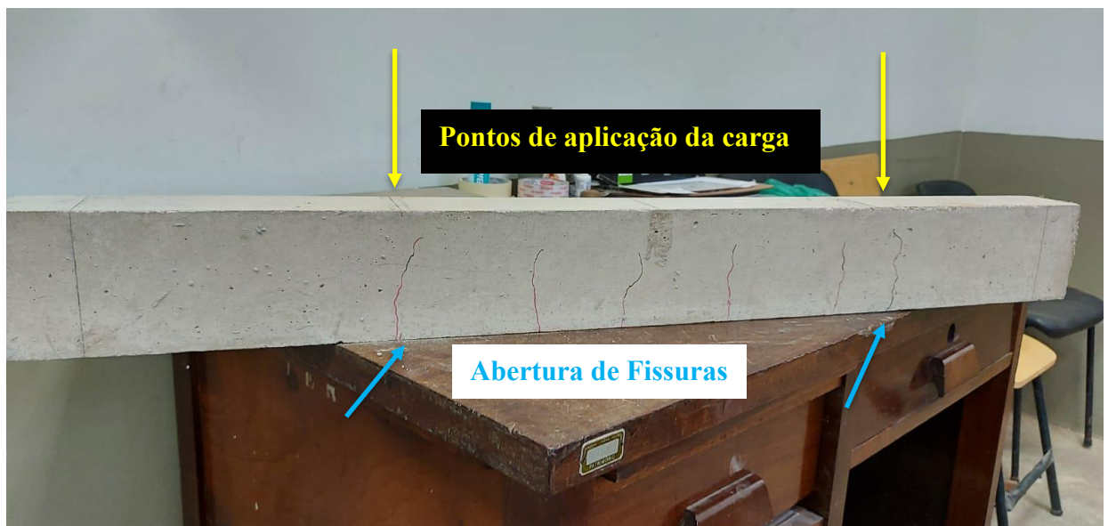
Figura 4.14: Viga V3 após a solicitação de 60% de sua carga última
