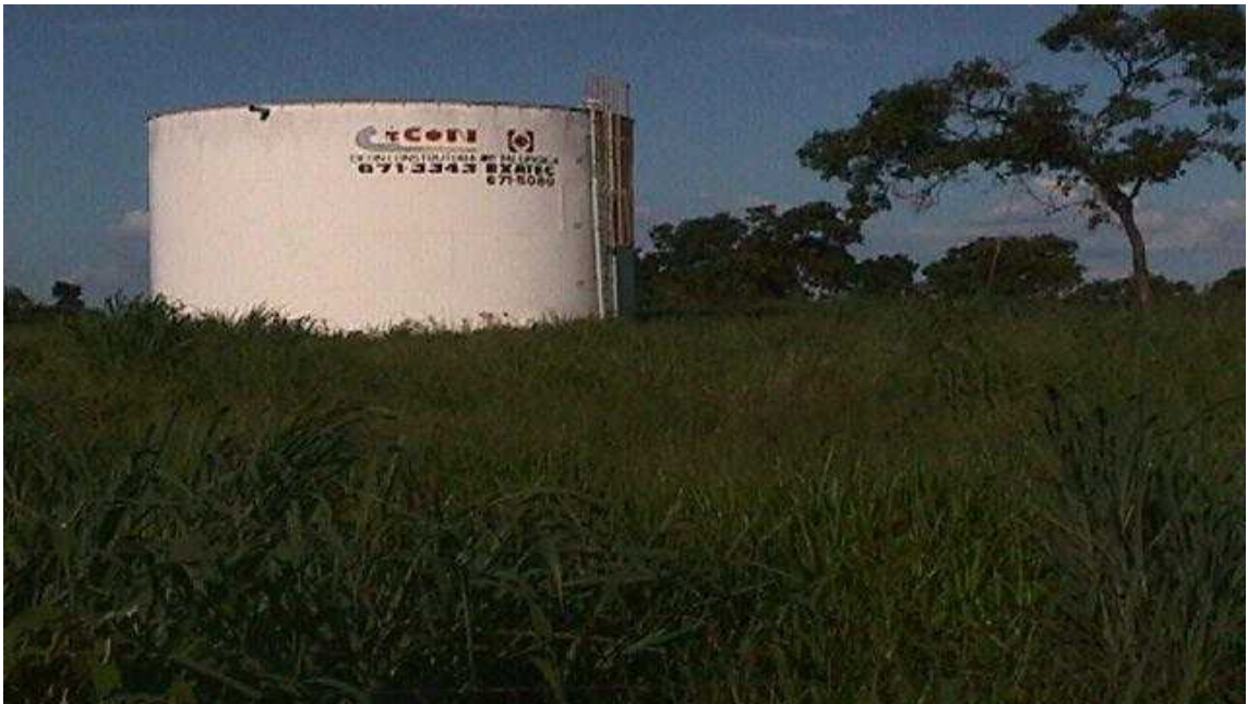
Figura 6 – Caixa de armazenamento do Condomínio das Águas
