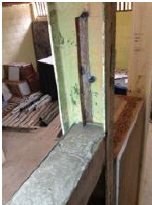
Figura 29 – Aspecto do elemento de concreto sobre a viga do pórtico.
