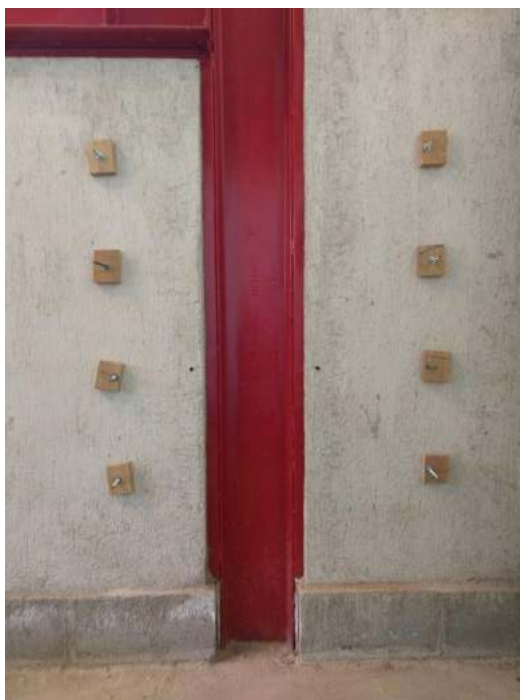
Figura 113 – Aspecto da base do perfil de aço da interface INT3-JV1-E1 após a realização do ensaio de estanqueidade à água.
