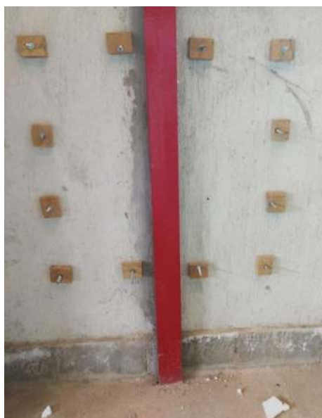
Figura 84 – Aspecto da base do perfil de aço da interface INT1-JV1-E1 após a realização do ensaio de estanqueidade à água.
