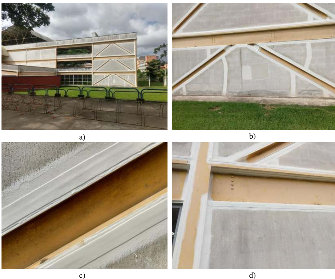
Figura 65 – Aspecto geral e detalhes do edifício PVB/UFV após o tratamento das interfaces com manta de elastômero EPDM.
