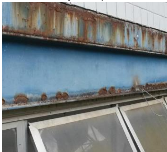
Figura 4 – Regiões de corrosão na interface entre o sistema de vedação e o perfil de aço.
