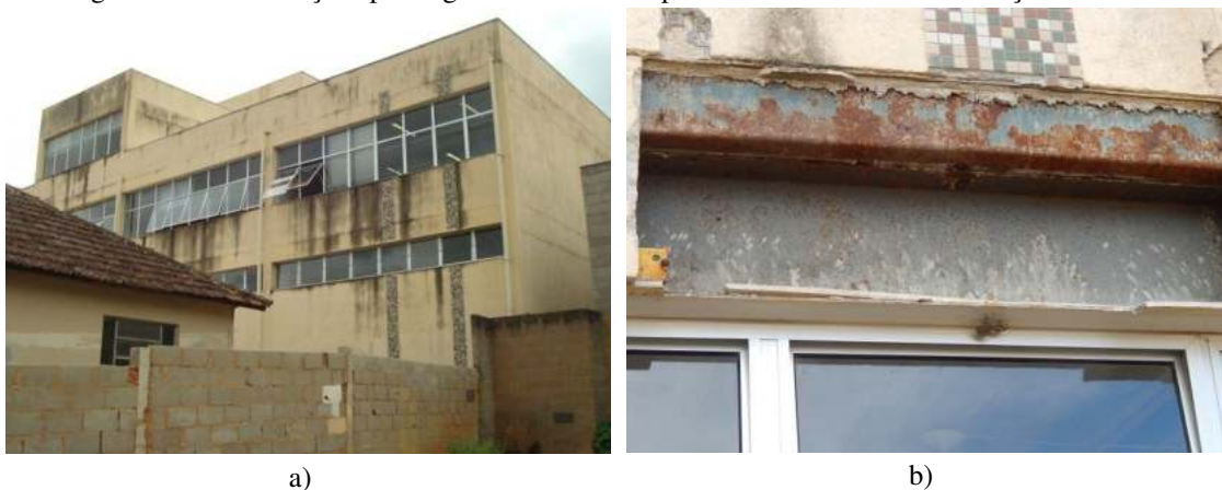
Figura 1 – Manifestações patológicas associadas a problemas no sistema de vedação vertical.
