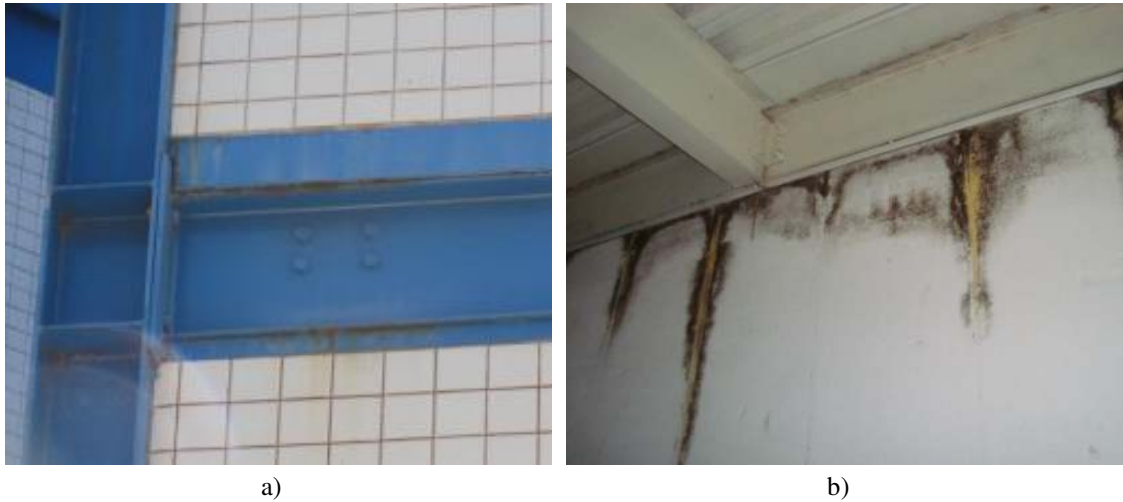
Figura 3 – Região com corrosão na interface entre revestimento e perfil de aço: a) exterior da edificação com corrosão no perfil, b) interior da edificação com corrosão no perfil e mofo no revestimento.
