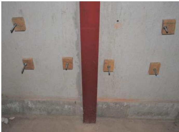
Figura 86 - Aspecto da base do perfil de aço da interface INT1-JV1-E2 após a realização do ensaio de estanqueidade à água.
