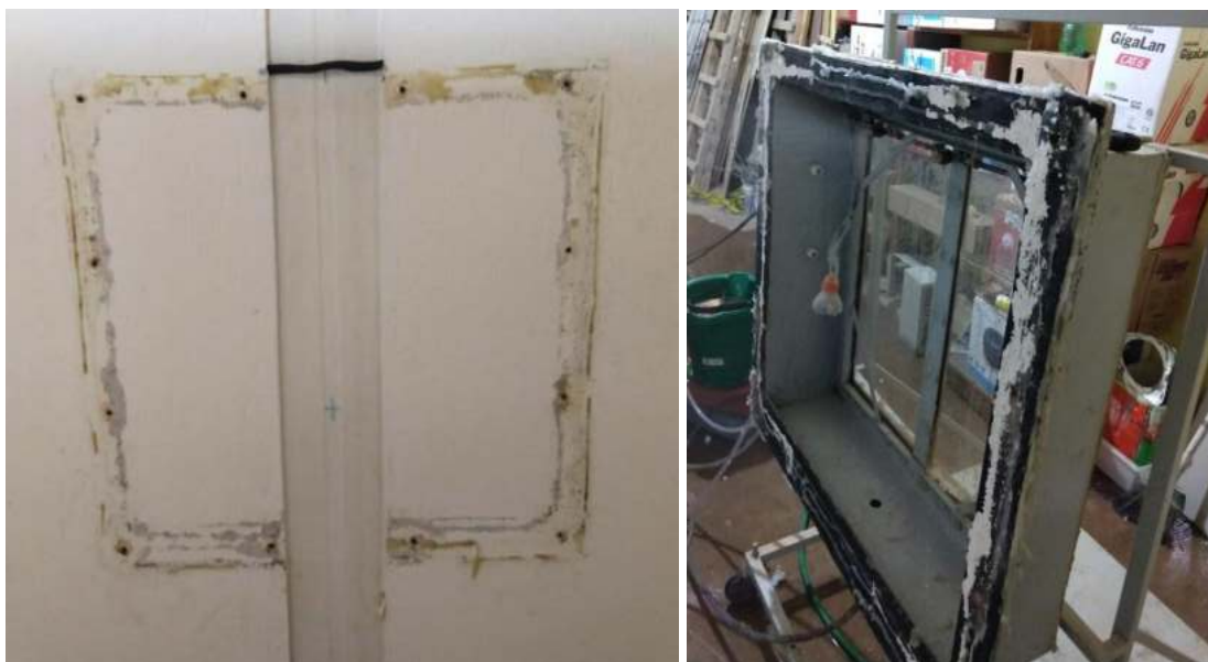
Figura 61 - Aspecto da parede e das borrachas de vedação após a retirada da câmara de estanqueidade.
