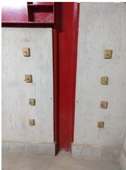
Figura 115 - Aspecto da base do perfil de aço da interface INT3-JV1-E2 após a realização do ensaio de estanqueidade à água.
