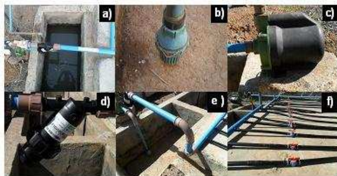
Figura 4 - Componentes principais do sistema de irrigação localizado por gotejamento: (a) reservatório de esgoto água residuária; (b) válvula de pé; (c) conjunto motobomba; (d) filtro de disco; (e) linha principal de PVC, e (f) linhas laterais.
