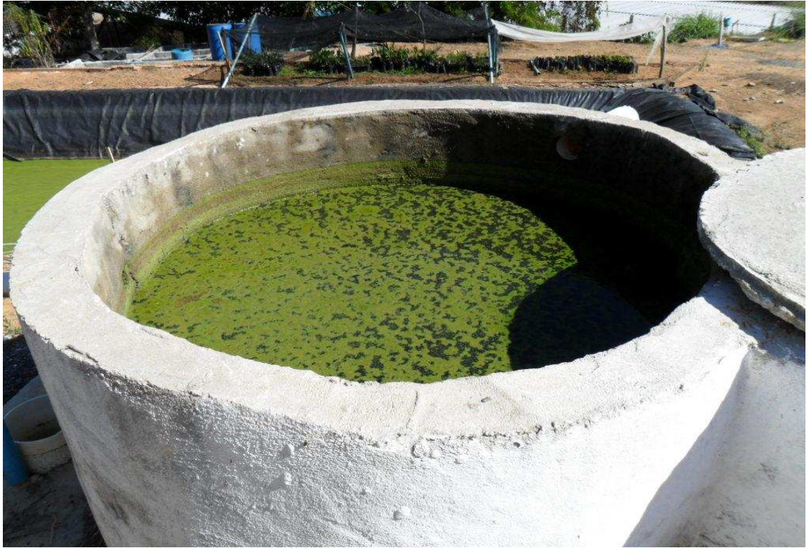
Figura 6 - Tanque séptico que armazena esgoto doméstico bruto.
