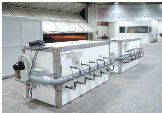
Figura 3. Vista do reator.
