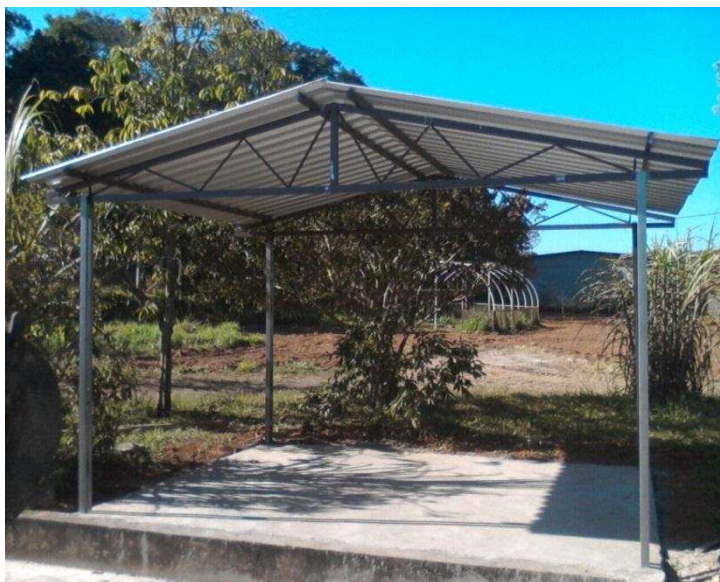
Figura 7. Vista do local onde foi instalado o protótipo.
