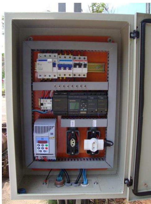
Figura 14. Componente eletrônico controlador do sistema de aeração.
