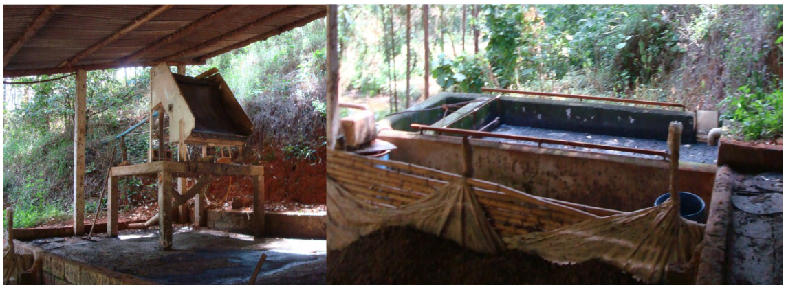
Figura 4.2: Peneira (à esquerda) e caixa de gordura (à direita) instaladas na propriedade antes do período experimental.
