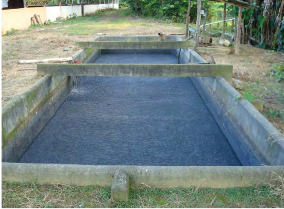
Figura 4.1: Tanque de retenção da ARS.
