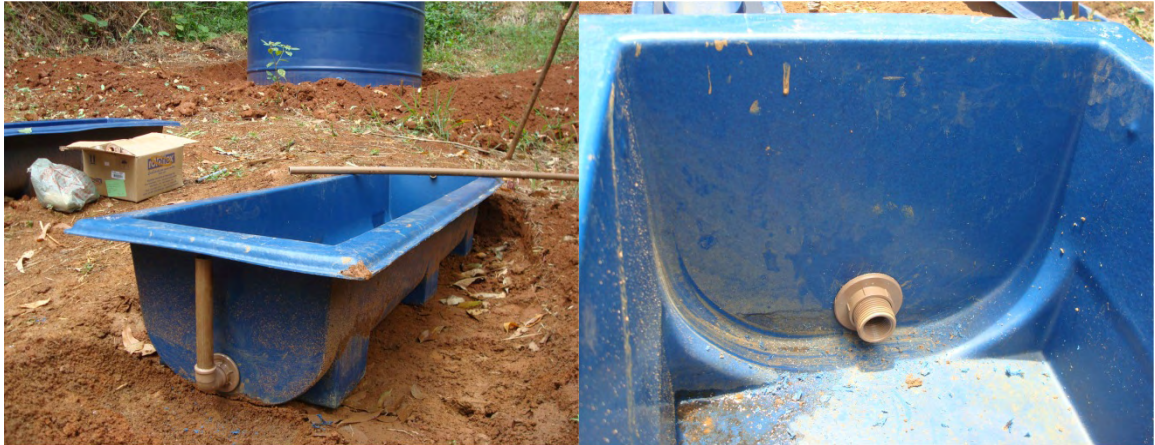
Figura 4.6: Vista externa (à esquerda) e vista interna (à direita) do dreno de saída de uma das unidades dos SACs.
