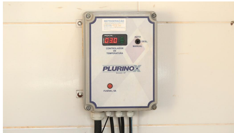
Figura 3 - Temperatura no controlador do tanque de resfriamento
