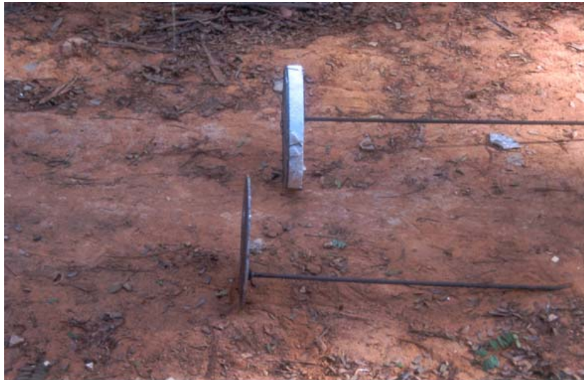
Figura 3.5 – Chapa de aço, haste e isopor (30 mm espessura) – ponta e topo da estaca
