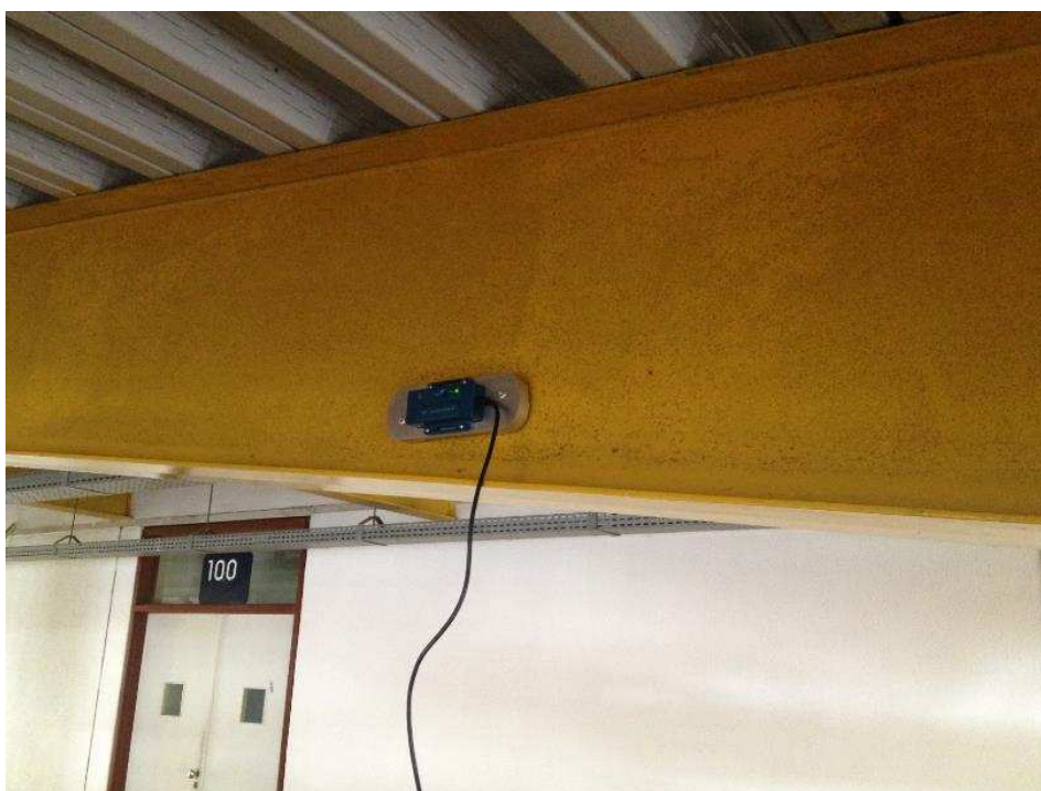
Figura 4-6 – Posicionamento do acelerômetro no ponto P01 (AC 1169) na alma da viga longitudinal da rampa de acesso.
