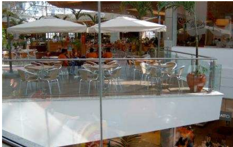
Figura 2-8 – Aspecto geral da varanda que apresentava vibrações excessivas.
