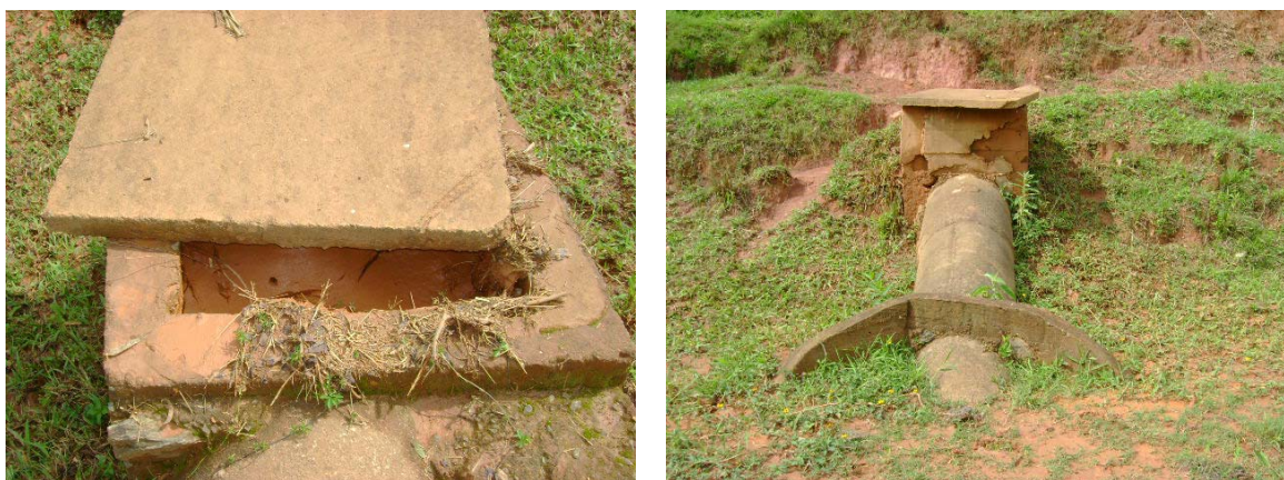
Figura 2: Caixa coletora obstruída em trecho viário da VCS 346, Viçosa-MG.
