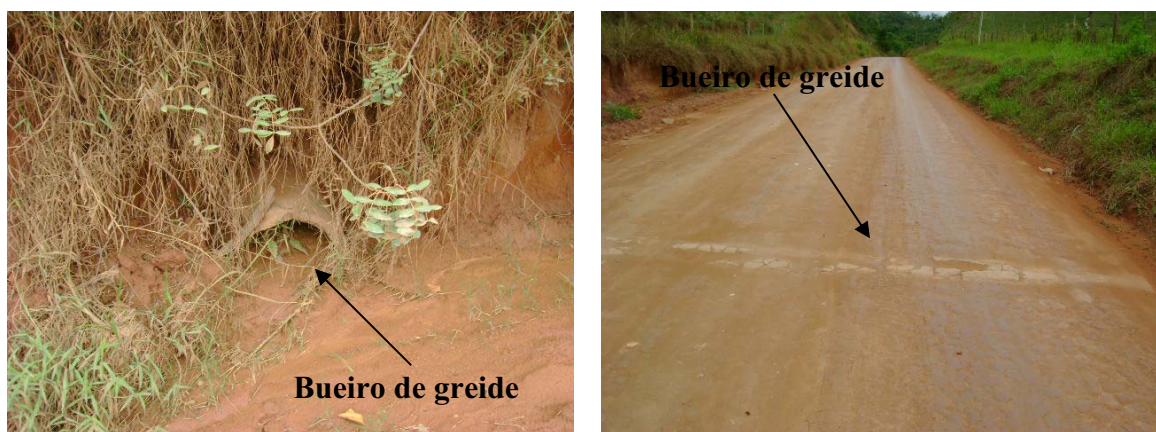
Figura 1: Bueiro de greide aparente devido o patrolamento excessivo
