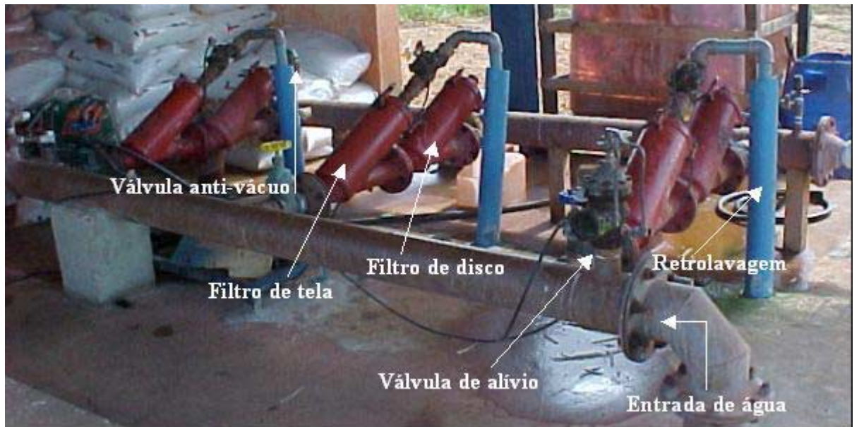
Figura 3.2 – Cabeçal de controle mostrando filtros e válvulas .
