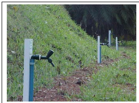
Figura 3 – Torneiras para amostragem de ao longo da rede de distribuição piloto enterrada.
