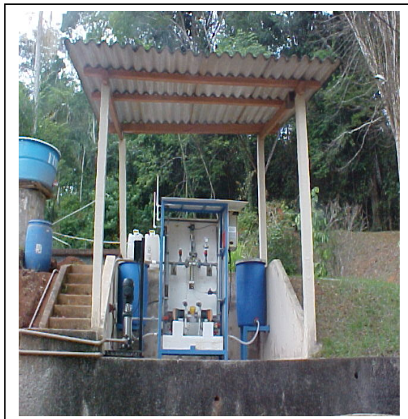
Figura 1 – Gerador de Dióxido de Cloro SVP-Pure® (Eka Chemicals do Brasil) instalado na ETA UFV.
