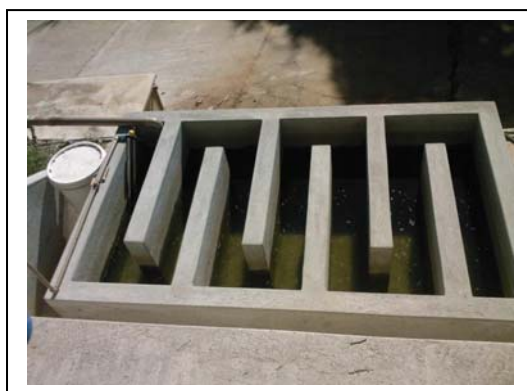
Figura 2 – Tanque de contato piloto em alvenaria com capacidade de 1,2 \text{ m}^3 , dividido em sete câmaras.
