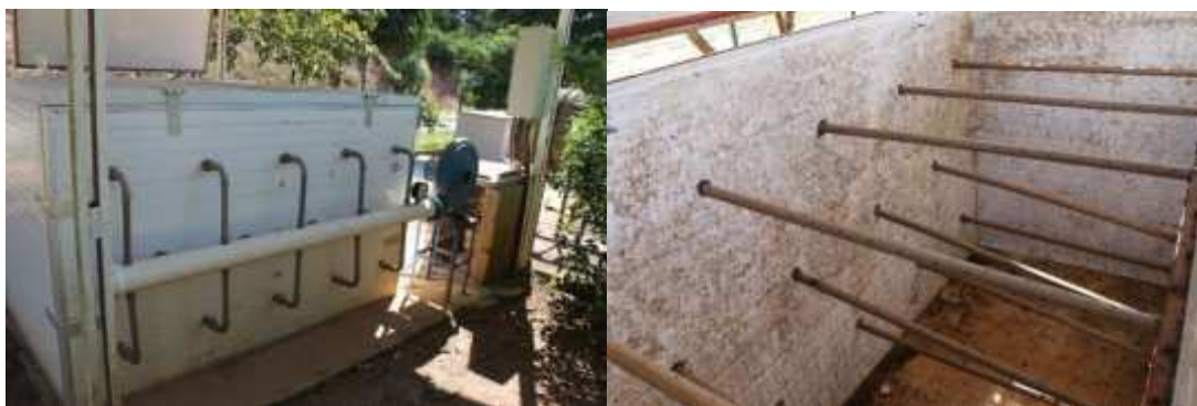
Figura 1. Vista externa e interna dos tubos de aeração do biorreator aeróbio descontínuo
