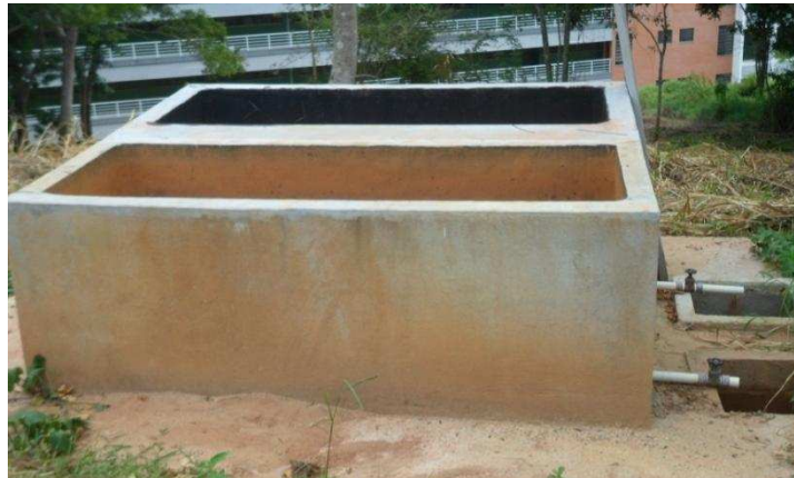
Figura 4.7 – Leitos de secagem de lodo em escala piloto instalados nas dependências da ETA UFV.
