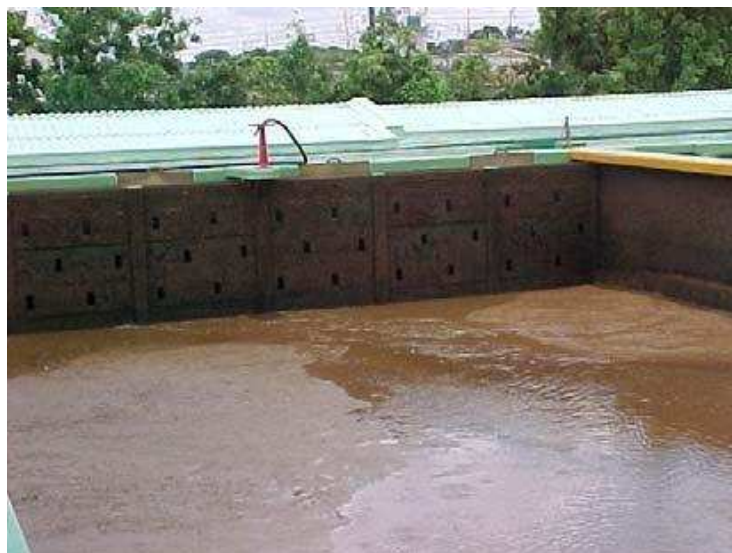
Figura 3.2 – Lodo acumulado em decantador convencional.
