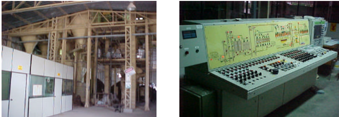
Figura 3.2. Sala de controle e proteção da fábrica de ração.
