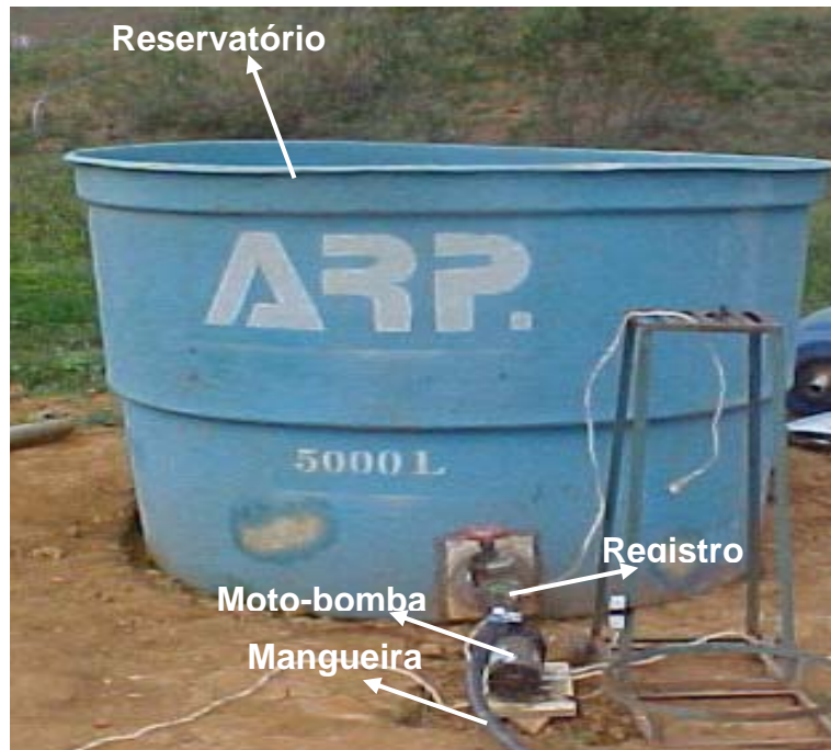
Figura 3.13. Detalhe do reservatório de água e do conjunto moto-bomba.
